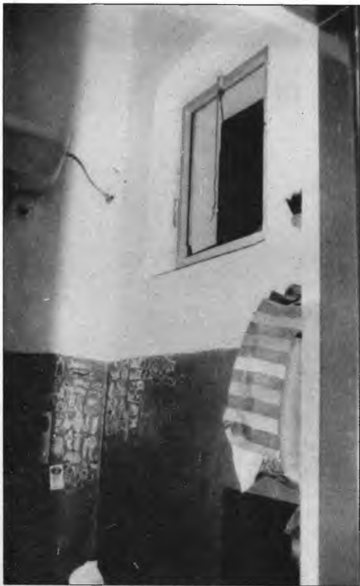
Okno světlíku, kterým útočník vnikl do bytu
