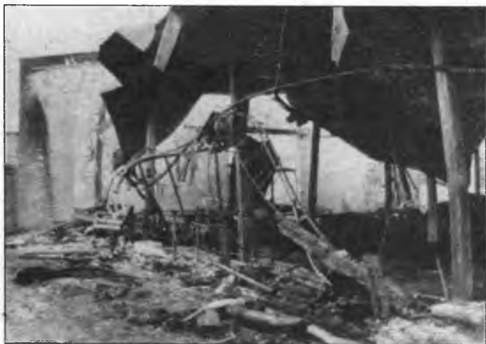
Hala dřevařského závodu v Trhanově vzala při požáru zasvě
